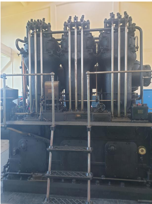
Tłoki silnika czterosuwowego w budynku pomp.
